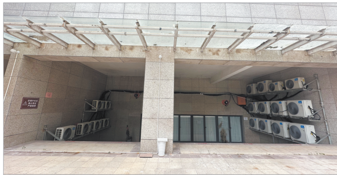
架空层里悬挂十八台空调外机
