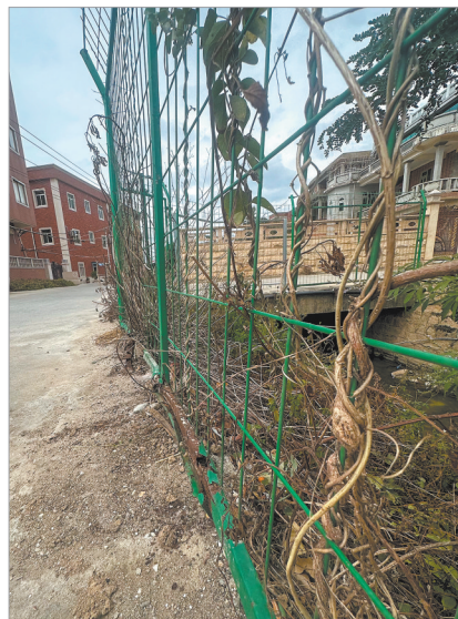
防护网锈迹斑斑,甚至出现断裂。
