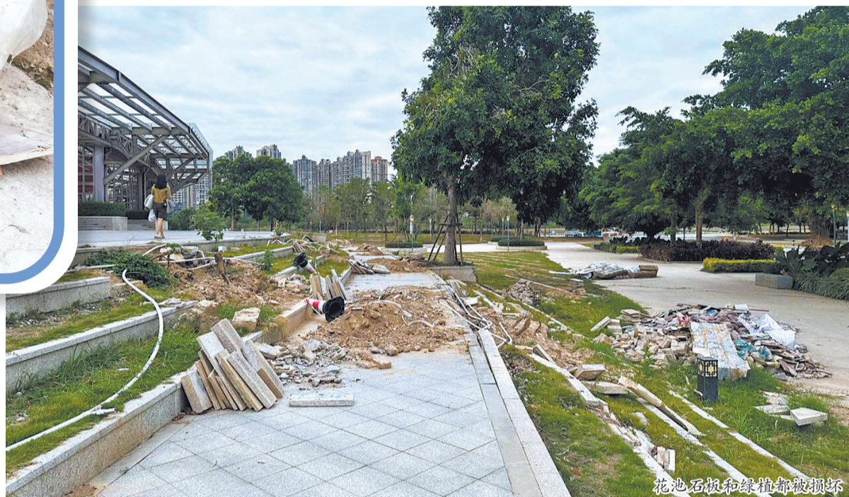
花池石板和绿植都被损坏
