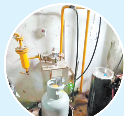
加热液化气瓶存在安全隐患
