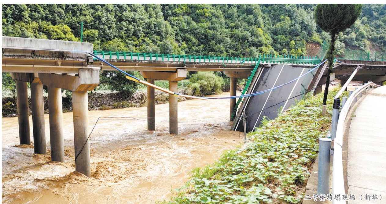
二号桥垮塌现场(新华)
