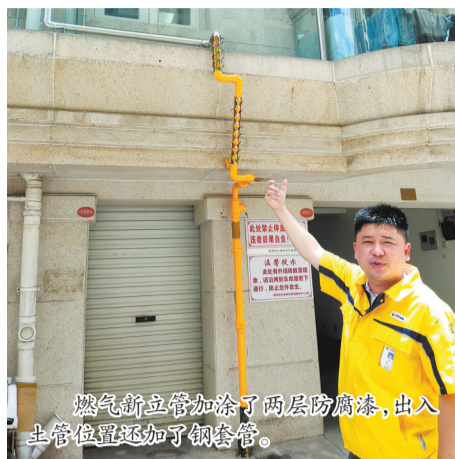
燃气管道加涂了防腐漆,出入土管位置还加了钢套管。
