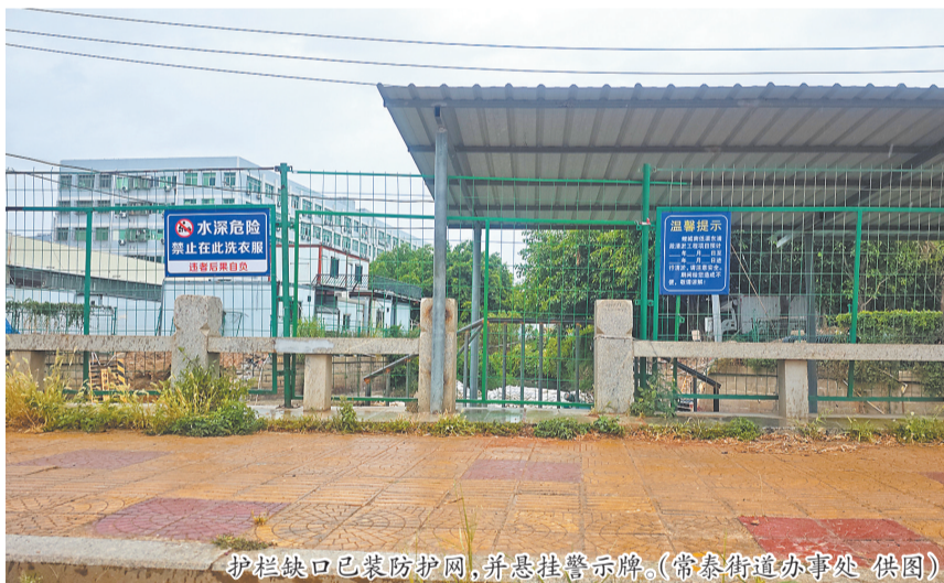
护栏缺口已装防护网,并悬挂警示牌。(常泰街道办事处 供图)
