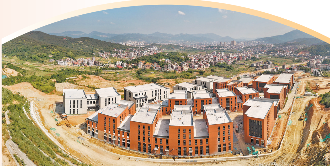
省级重点项目——五矿智慧工场·中国(南安)高端阀门智造产业园项目一期首开区已竣工验收,计划11月底交付。该项目位于南安市英都镇,占地1082亩,总投资约50亿元,将通过“强链补链”,形成上下游企业优势互补、信息互通、资源共享的产业链生态,打造中国最具影响力的阀门产业集聚区。(融媒体记者林功峰 吴宗宝 通讯员陈鑫炜 林婧 陈楚君 摄)
