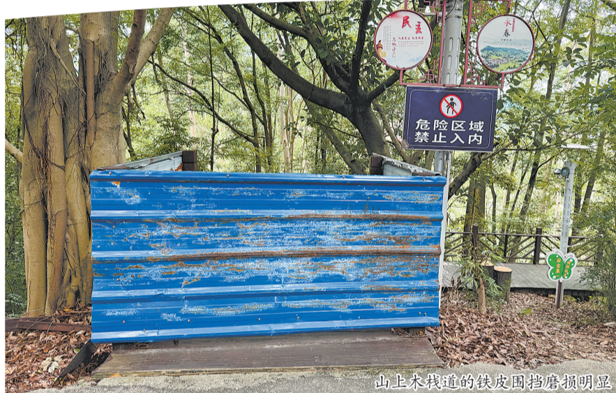
山上木栈道的铁皮围挡破损明显
