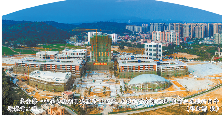
惠安第一中学分校项目总投资10亿元,主建筑已全部封顶,目前正在进行内外墙装饰工程。(邓文群 摄)
