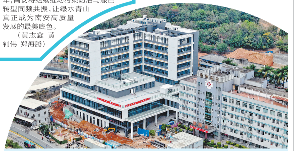
南安市南侨医院综合楼项目主体已封顶、外立面完工,目前正进行内部装修扫尾,预计4月底竣工。该项目总投资约1.2亿元,建成后总床位达500张,将惠及诗山、金淘等5个乡镇近30万人口,有效推动南安卫生健康事业高质量发展。今年1至2月,南安513个在建重点项目累计完成投资151.67亿元,占年度计划893.85亿元的16.97%,超时序进度0.3个百分点。图为南侨医院综合楼项目建设现场。(黄奕群 摄)
