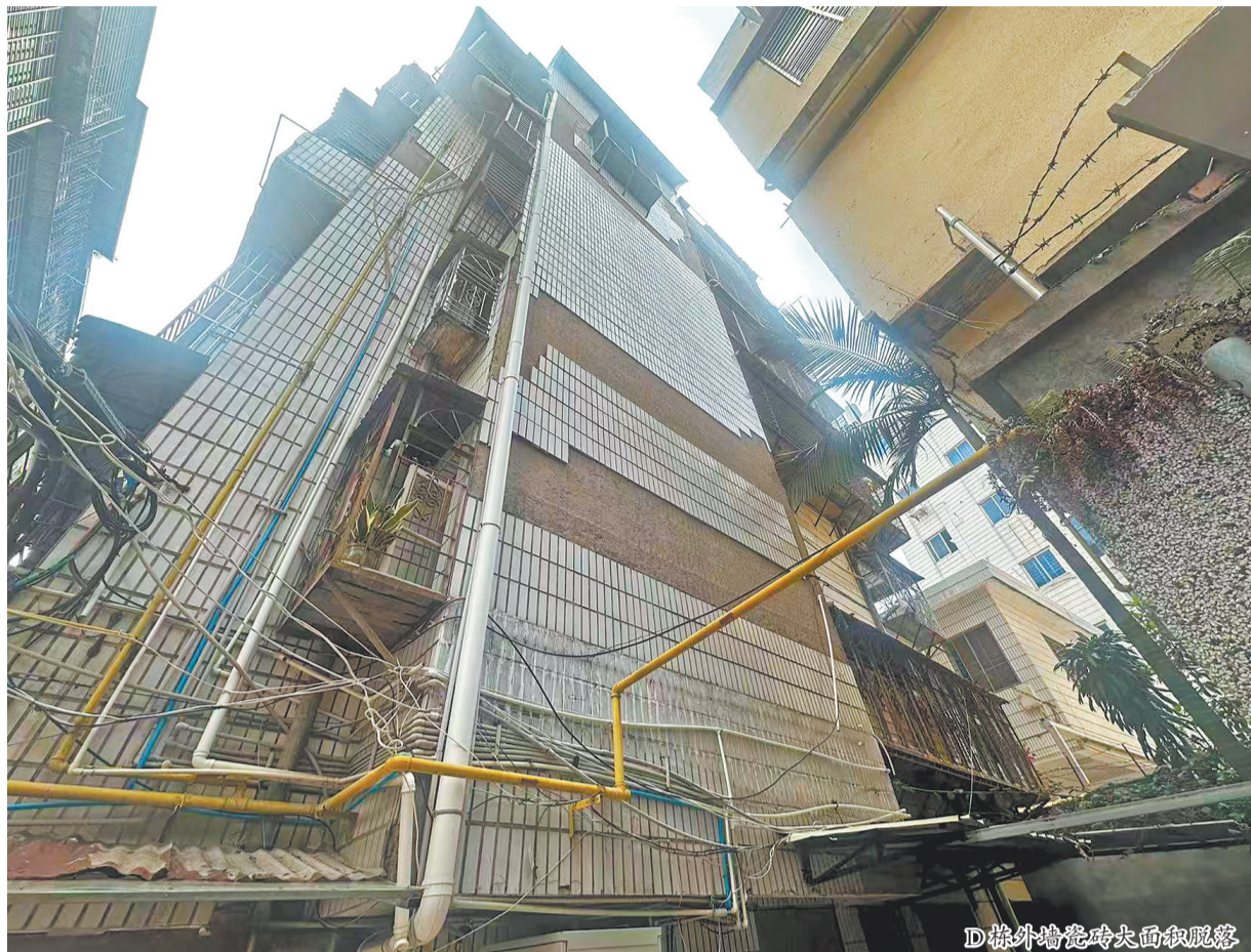
D栋外墙瓷砖大面积脱落
