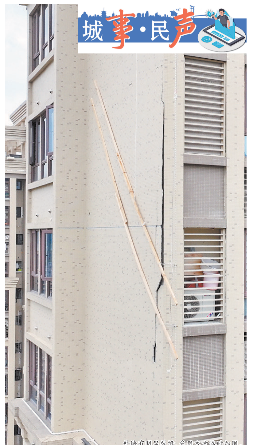
外墙有明显裂缝,采用木方临时加固。
