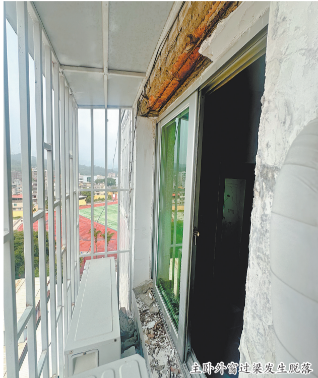
主卧外窗过梁发生脱落
