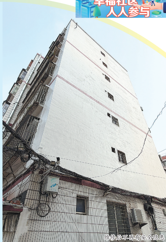
维修后不再有安全隐患
