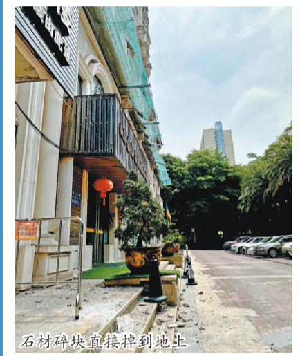
石材碎块直接掉到地上
