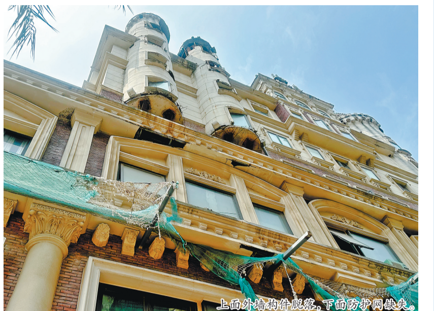
上为外墙构件脱落,下为防护网缺失
