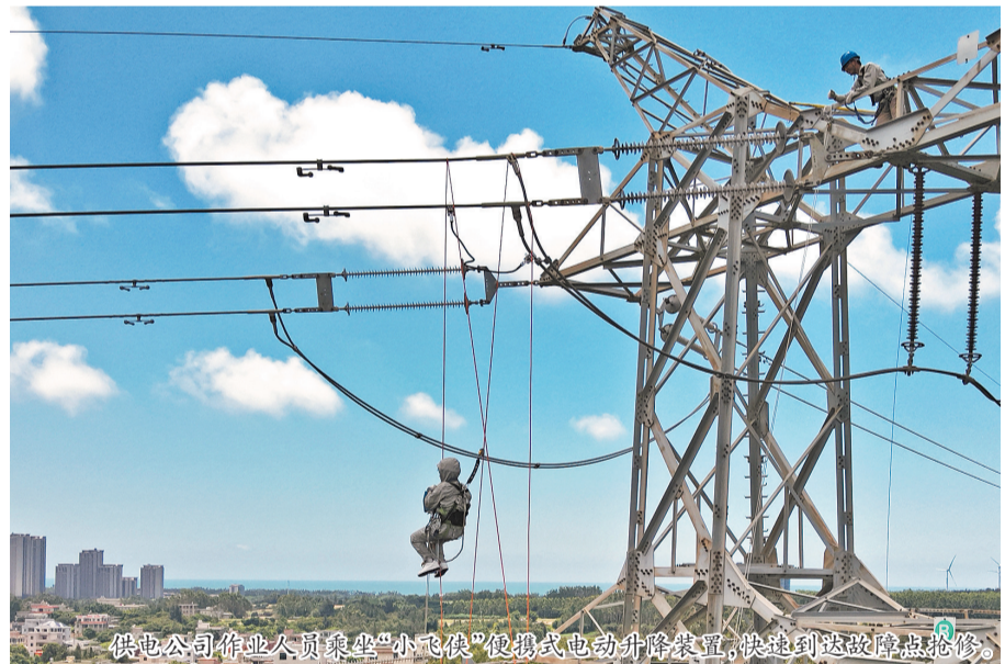
供电公司作业人员乘坐“小飞侠”便携式电动升降装置,快速到达故障点抢修。
