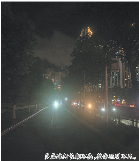
多盏路灯长期不亮,整体照明不足。
