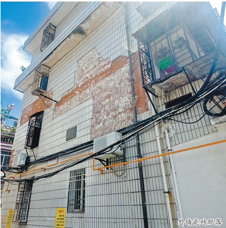
外墙瓷砖脱落
