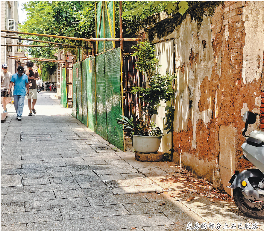
危房的部分土石已脱落
