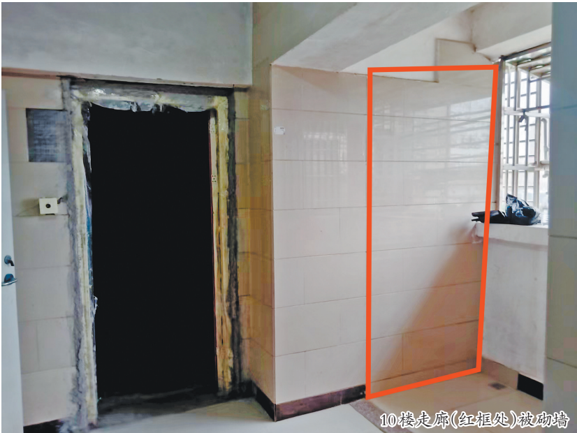
10楼走廊(红框处)被砌墙
