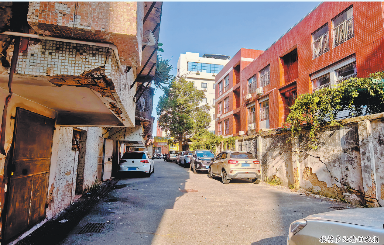
楼栋多处墙面破损
