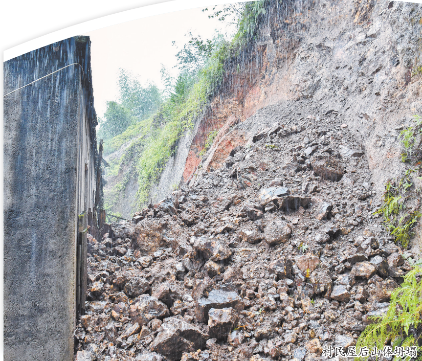
村民屋后山体坍塌
