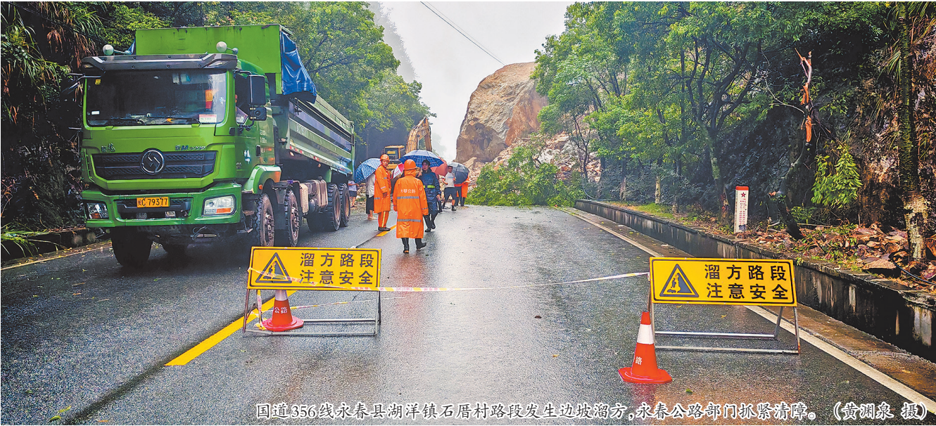
国道356线永春县湖洋镇石厝村路段发生边坡溜方,永春公路部门抓紧清障。(黄调象 摄)
