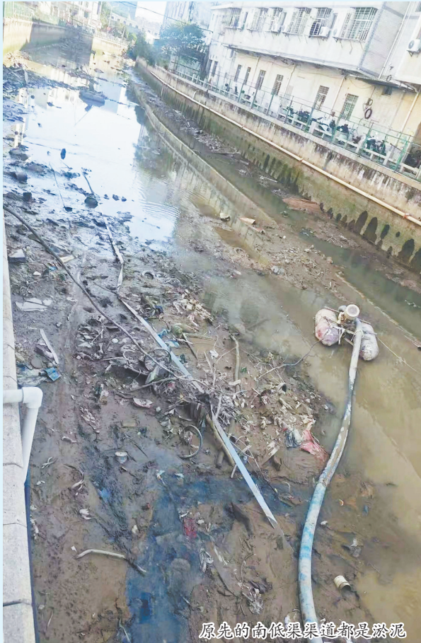
原先的南低渠渠道都是淤泥
