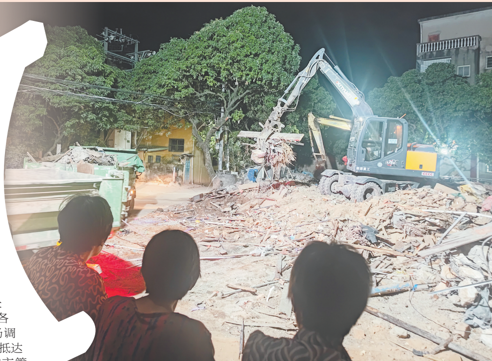
深夜,多名村民看着支援队清理倒塌祖厝的废墟,眼里满是感激。
