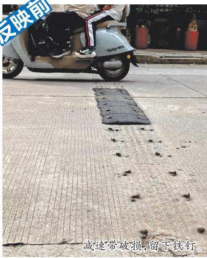
减速带破损,留下铁钉。
