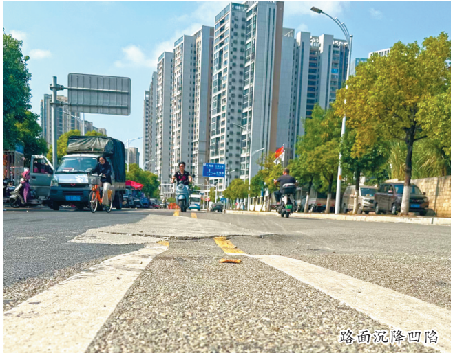
路面沉降凹陷
