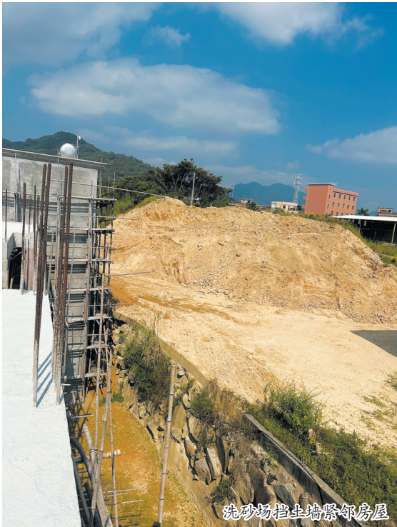
土石冲入造成房屋损坏
