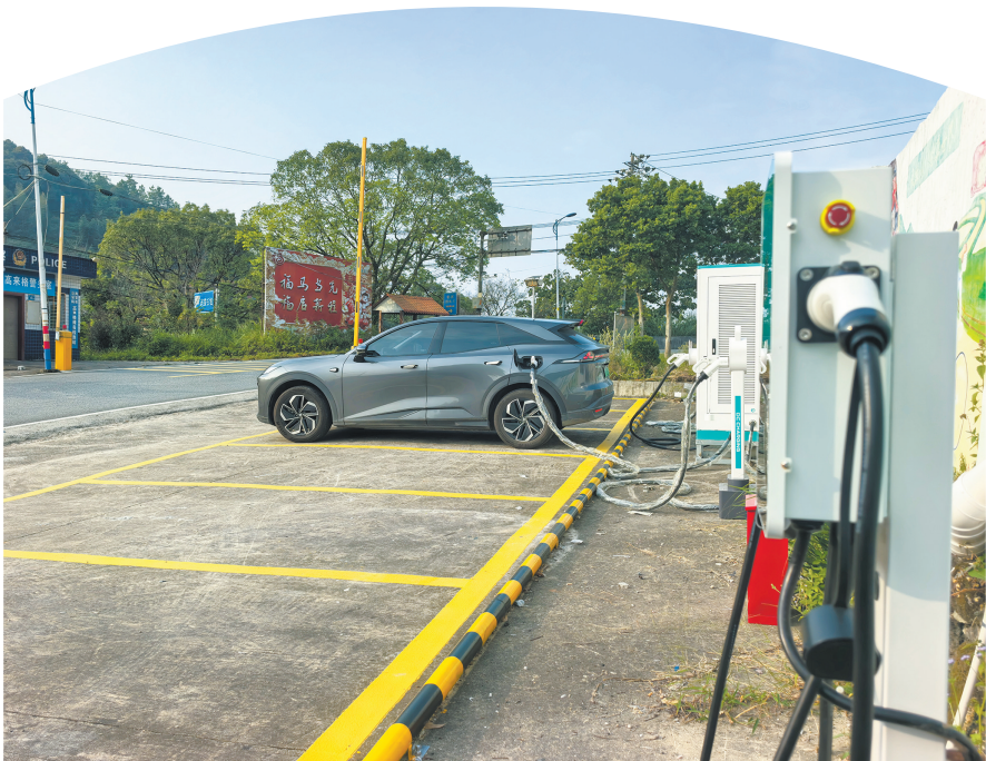
新村村的充电站紧邻县道331线
